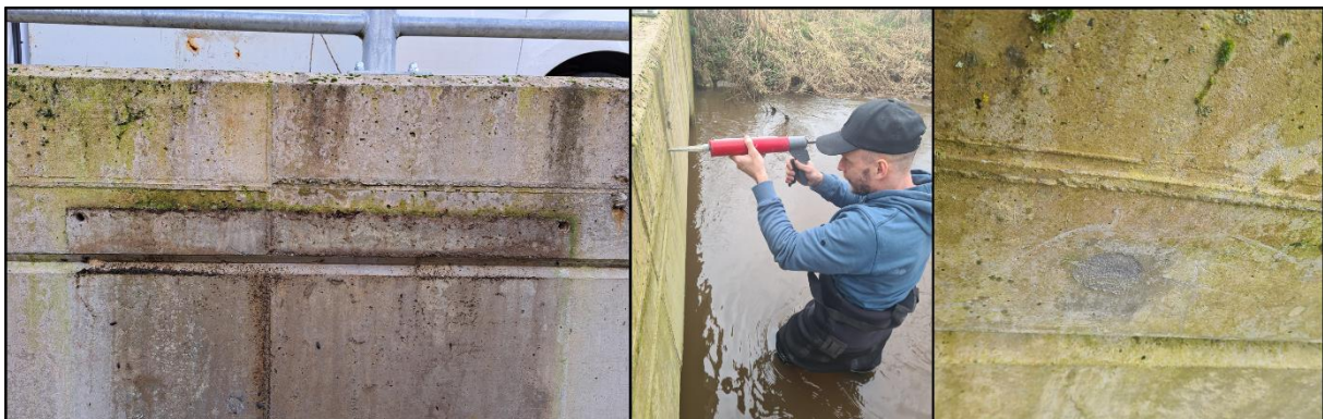
Figuur 3: De nodige boorgaten (links) voor het ophangen van de schakelkast (Figuur 2) werden in maart 2024 vakkundig gestopt door KBTS (midden en rechts). © KBTS.
