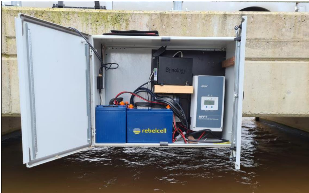
Figuur 2: De metalen kast met technische voorzieningen. © KBTS.
