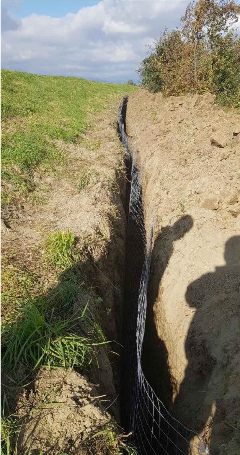
Figuur 2.2.10: Aanbrengen van een metalen raster in de voet van de dijk
