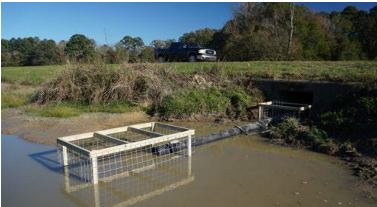
Figuur 2.2.21: Kooi met gaas voor een duiker om te voorkomen dat een bever het dichtstopt met takken en modder, waarbij een verlenging met een buis en filter is toegepast. De foto geeft de situatie bij relatief lage waterstanden (S. Lisle).
