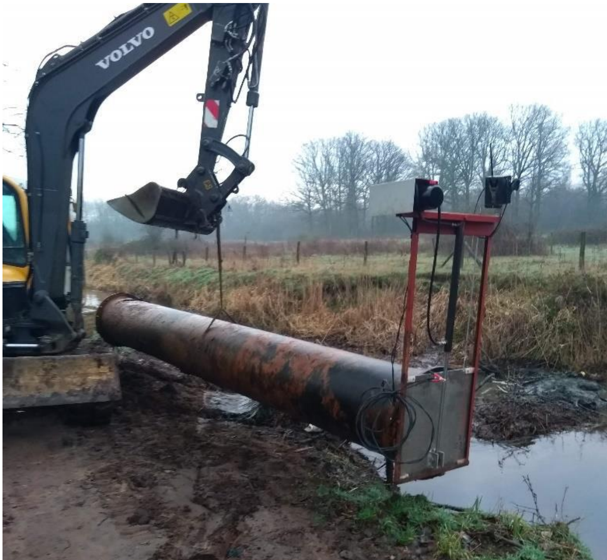
Figuur 2.2.33: Beaver Deceiver met afsluitbare instroom: het rode frame laat toe om de metalen klep naar boven te hijsen (buis open) of naar beneden te laten zakken (buis toe) waardoor de doorstroom kan geregeld worden.
