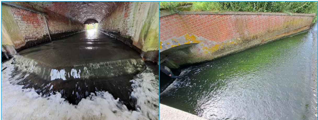
Figuur 7: Foto's van het migratieknelpunt aan de monding van de Eeklose Watergang. Links: De 2 kleine drempeltjes en het grotere verval met luchtgordijn. Rechts: De lange bodemplaat met zeer ondiepe waterkolom gevolgd door een klein verval naar het Leopoldkanaal. © Mechtild Zoeter Vanpoucke
