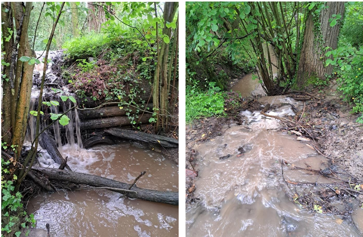
Figuur 1: Foto's genomen van het brongebied van de Krombeek (locatie 42). De duiker zit verstopt en de beek is stroomopwaarts volledig opgevuld met sediment (links). Let ook op de bruine kleur ten gevolge van erosie (rechts).
